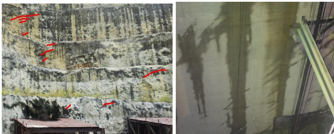
Figura 13-19: Fisuras de tracción en la ladera por encima de la plataforma de compuertas (izquierdo), posibles Fisuras de tracción en pozo de compuertas (derecho)
