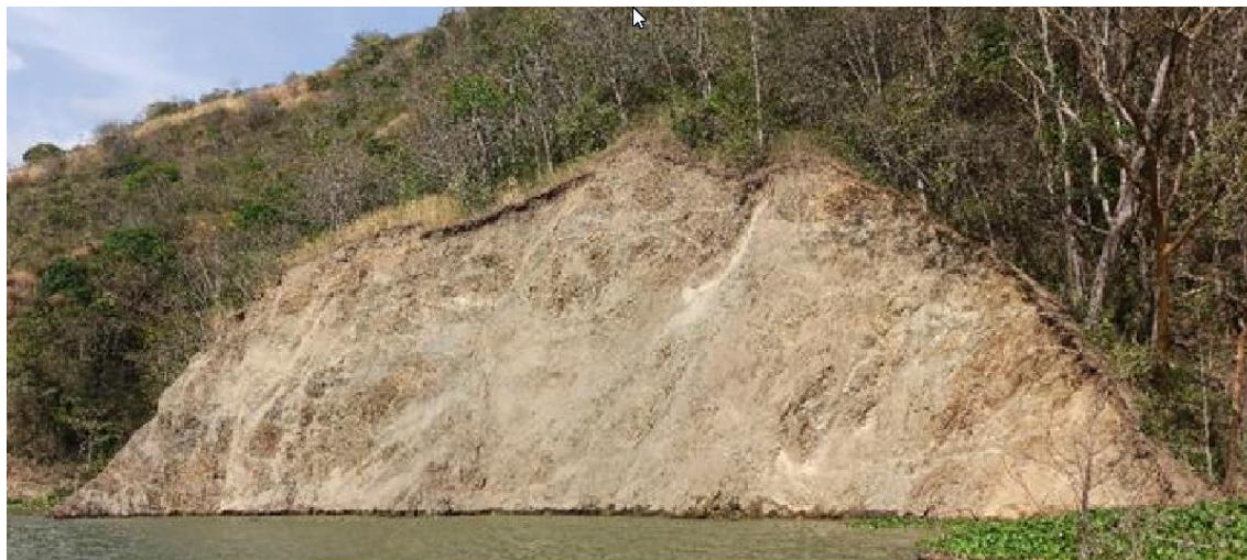
Figura 8-9: Sitio 25, según la numeración definido en los informes de monitoreo de EPM
