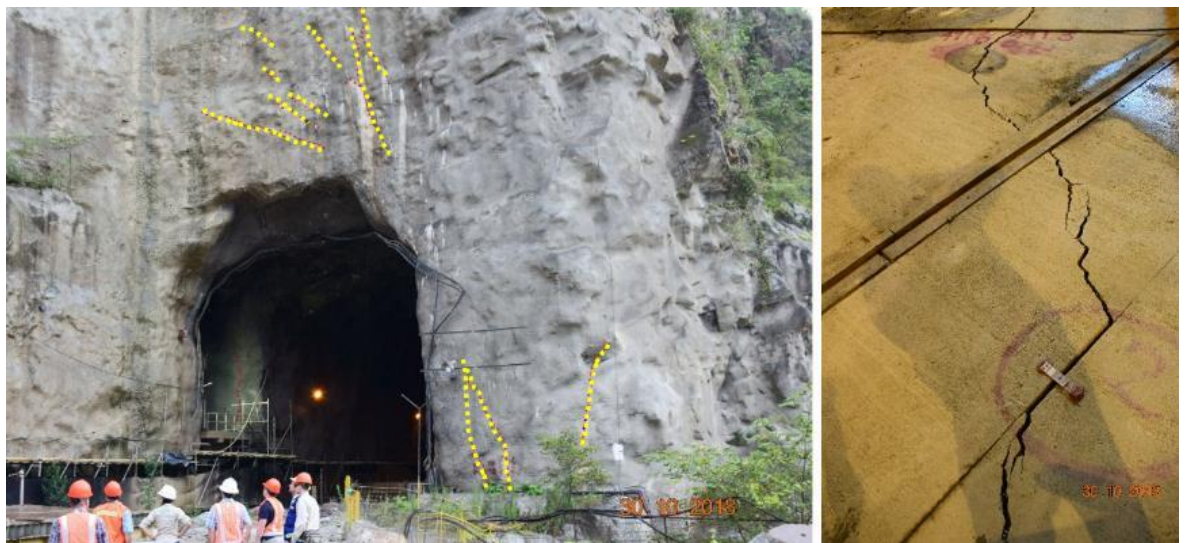
Figura 4-8: Vista de las grietas abiertas de la zona del Portal de Entrada de la Cámara de Compuertas de los pozos de Aducción, y una de las grietas del piso de dicha cámara
