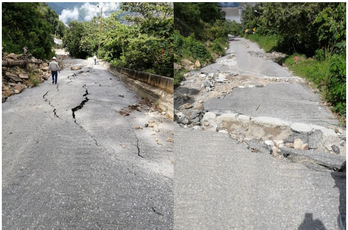
Figura 5-3: Daños en el sector que dan cuenta de las deformaciones que ha tenido esta ladera
