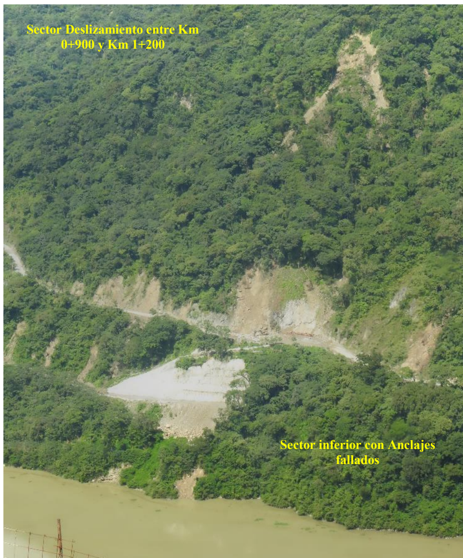
Figura 5-1: Vista del sector del Deslizamiento entre los Km 0+900 y Km 1+200. Se indica el sector inferior con los anclajes fallados.
