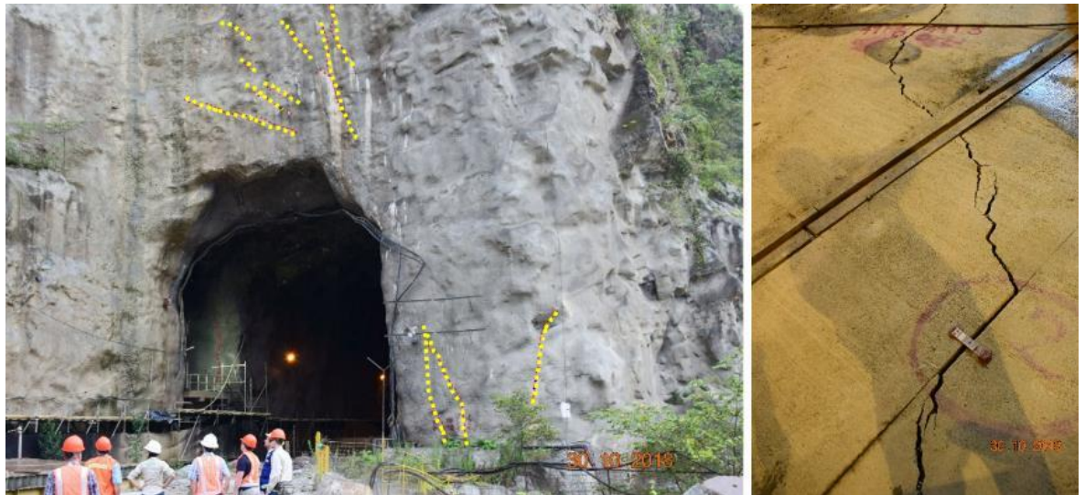
Figura 13-14: Vista de las grietas abiertas de la zona del Portal de Entrada de la Cámara de Compuertas de los pozos de Aducción, y una de las grietas del piso de dicha cámara.
