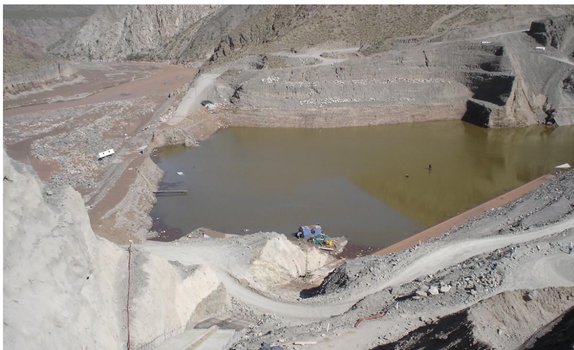
Figura 13-142: Ataguía dañada y obra inundada de la presa Caracoles
