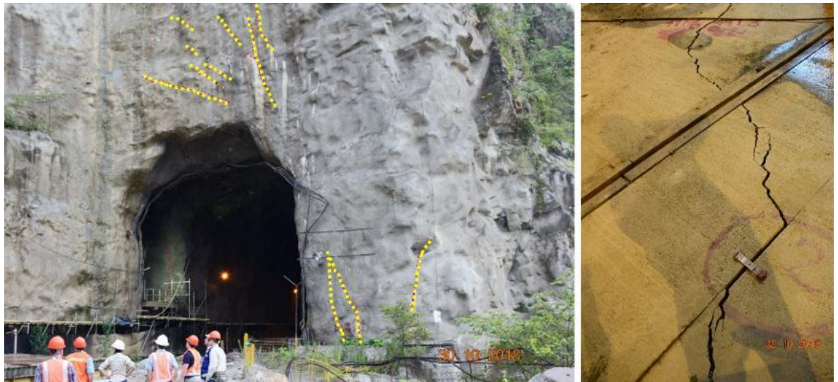
Figura 13-26: Vista de las grietas abiertas de la zona del Portal de Entrada de la Cámara de Compuertas de los pozos de Aducción, y una de las grietas del piso de dicha cámara
