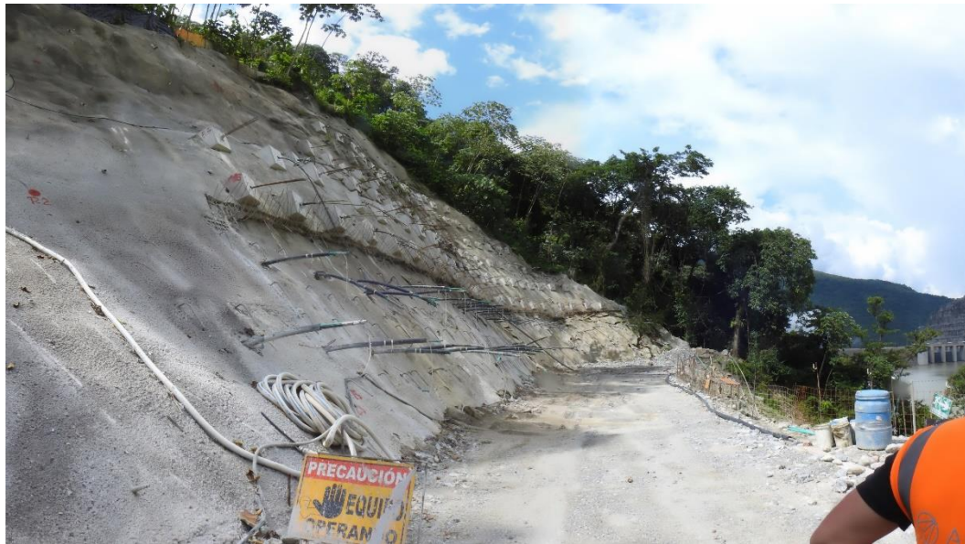
Figura 5-2: Vista de los anclajes fallados del sector inferior del deslizamiento del Km 0+900 a Km 1+200
