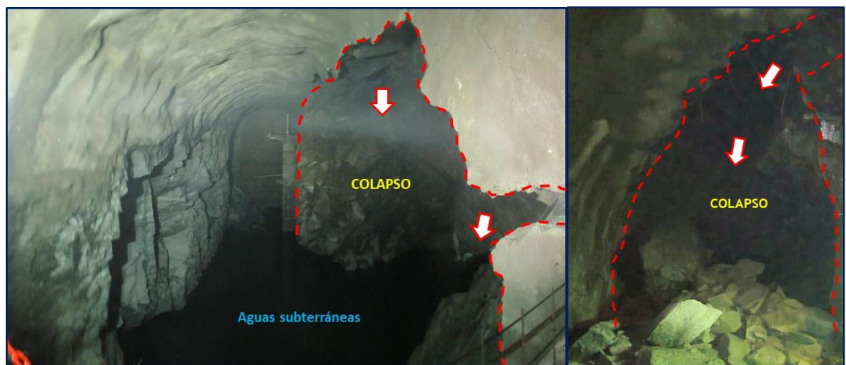
Figura 4-15: Vista de la Almenara Norte(Izq.) y del colapso en el pique de ventilación (Der.)
