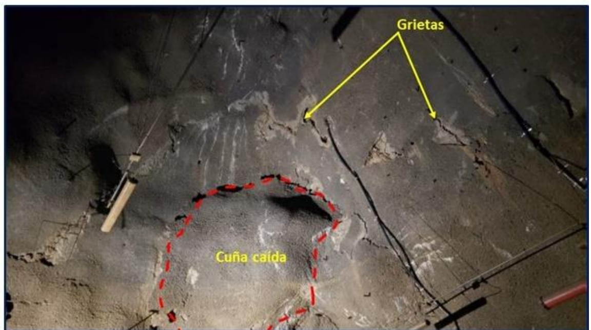
Figura 4-12: Daños en el sistema de fortificación en la zona sur de la caverna de transformadores
