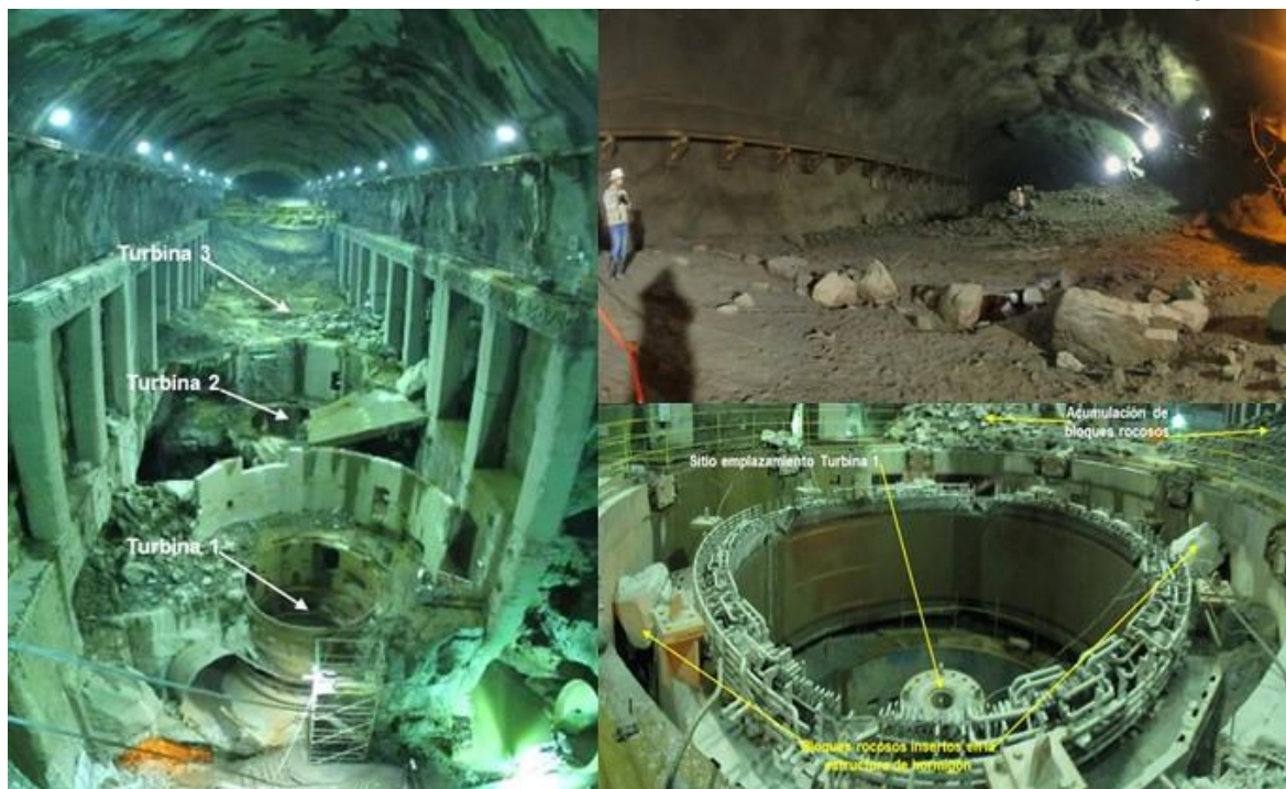
Figura 4-13: Vista de los daños en la Caverna de Máquinas
