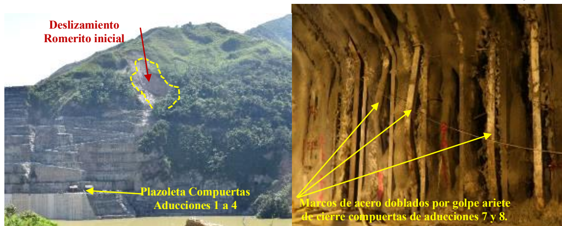
Figura 13-13: Derrumbe por encima de los pozos de compuertas y de la captación (Deslizamiento Romerito, izquierda), deformación de cerchas de acero en el Túnel Vial, las que tuvieron que ser reemplazadas y/o reforzadas (derecha)
