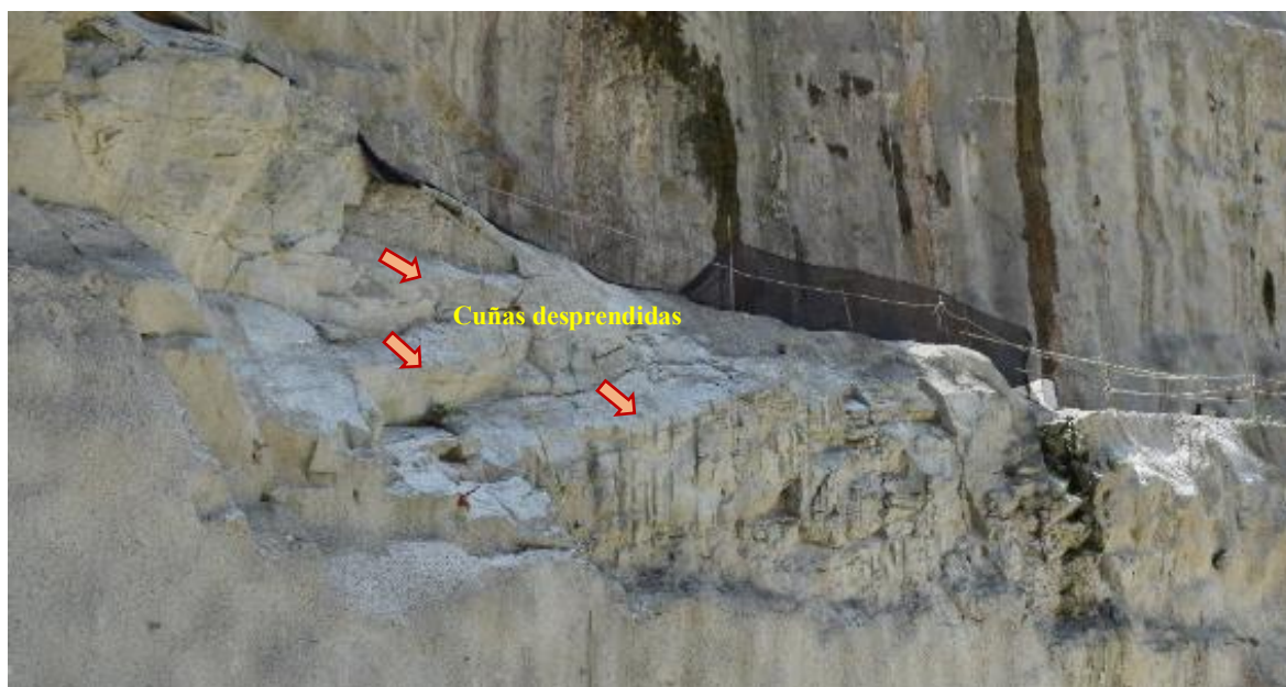
Figura 13-15: Desprendimiento de cuñas en planos de la foliación cerca del vertedero
