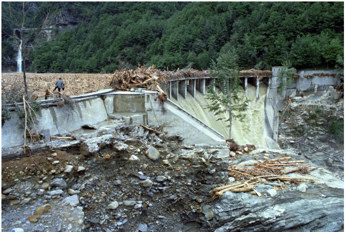
Figura 13-117: Bloqueo del vertedero en la presa Palagnedra, Suiza durante una crecida con arrastre de una alta cantidad de troncos, acaecida 1978
