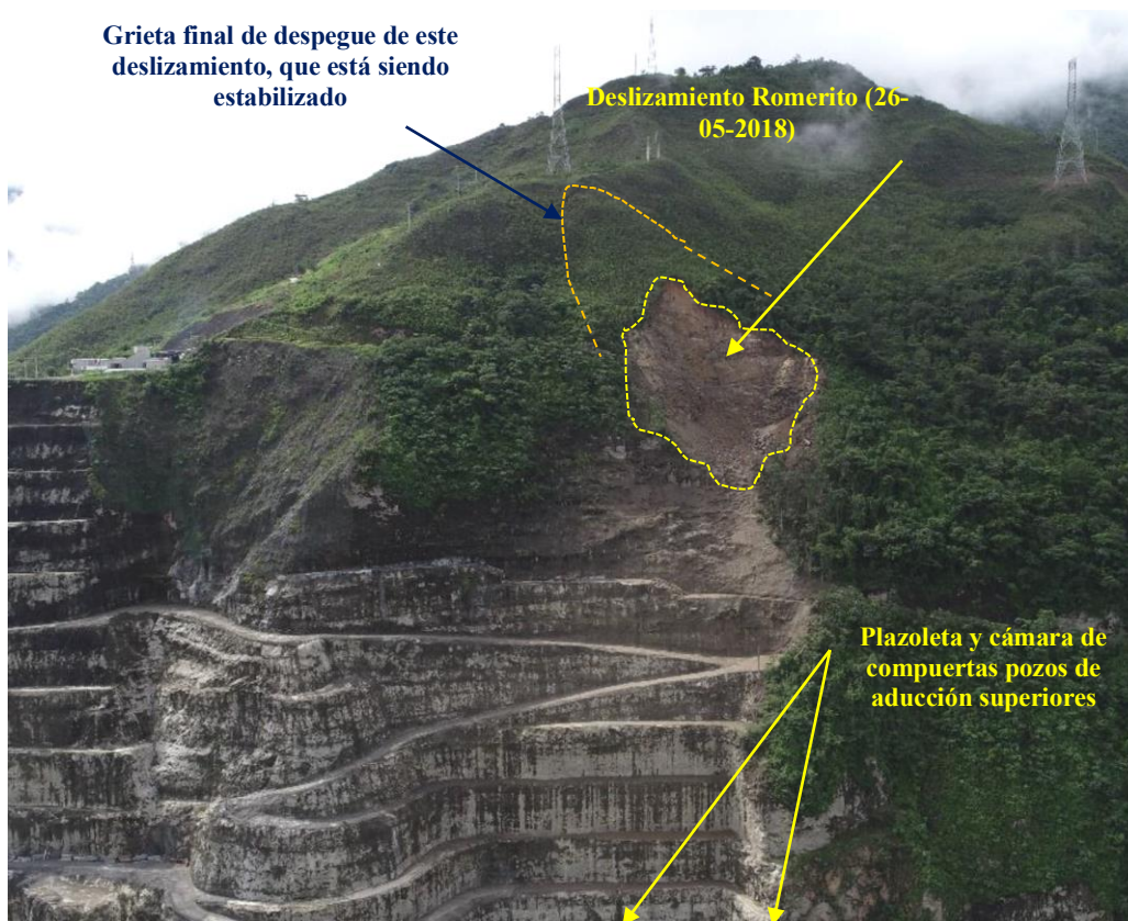
Figura 13-55: Vista del deslizamiento Romerito, después de ubicarlo sobre la plazoleta de compuertas.
