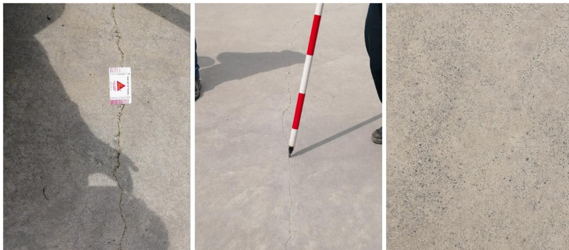
Figura 13-113: Grietas de retracción, erosión por desgaste de hormigón (izquierdo), (Integral presentación vertedero)
