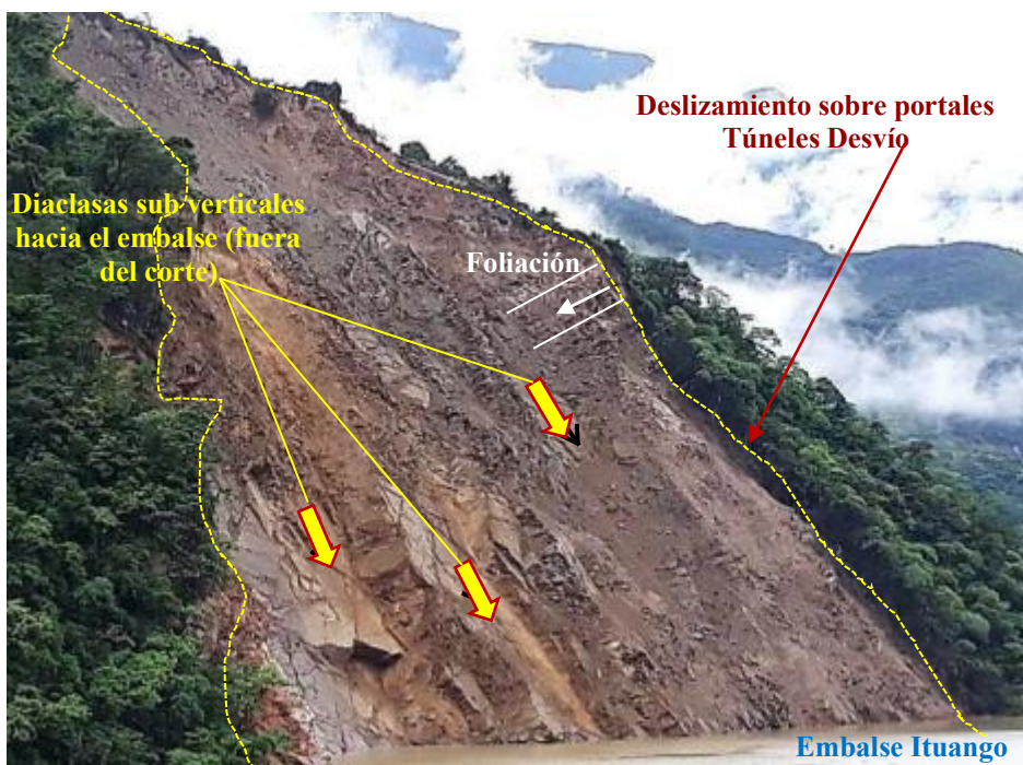
Figura 4-4: Vista del deslizamiento ocurrido sobre los portales de túneles de desvío, el 16 de mayo de 2018, correspondiente al 2º pulso o evento de este colapso
