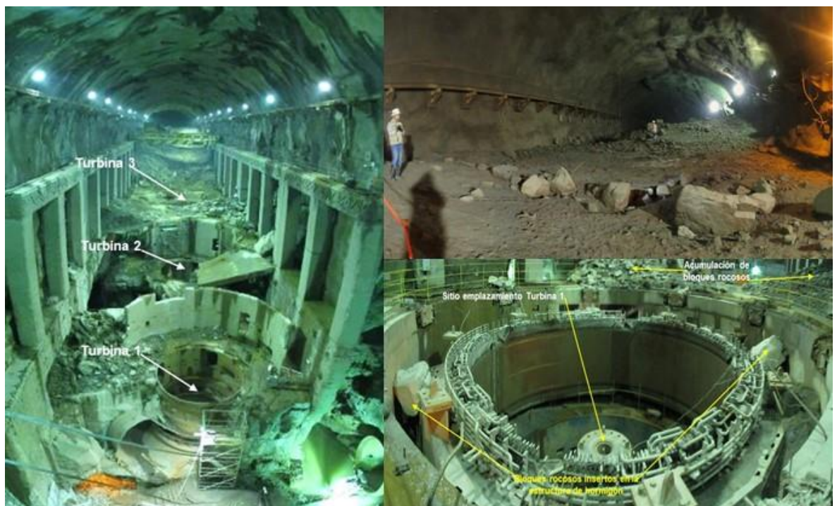
Figura 13-35: Vista de los daños en la Caverna de Máquinas
